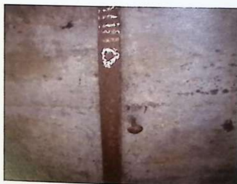
Foto 15. Señalización medidas en cuba.
